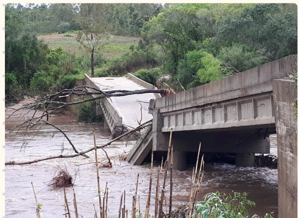
Figura 10 - Queda da ponte que ligava duas cidades no RS.
